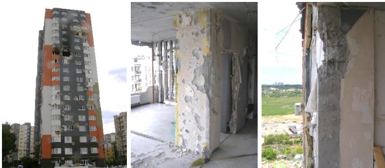
Рис. 1. Пошкодження конструктивних елементів будівлі під дією хвильових імпульсних впливів
