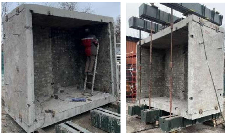
Рис. 1. Загальний вигляд фрагменту сховища ( a ) та загальний вигляд захисної споруди з наявними пошкодженнями ( б )
