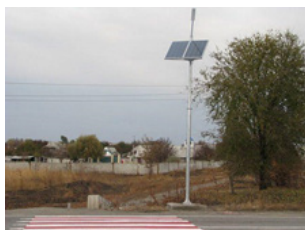
Рис.1-а. Ліхтарі з сонячними панелями біля траси Київ-Чоп
